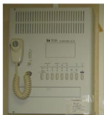
放送設備 (宿舎全体に放送できます)
