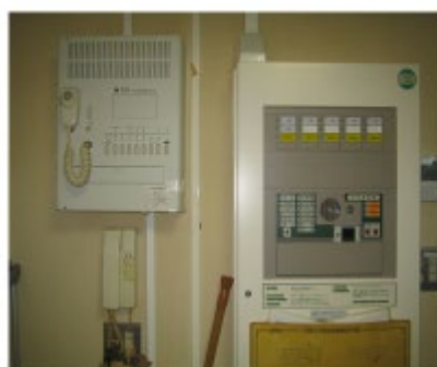
右: 火災受信器 左: 放送設備
