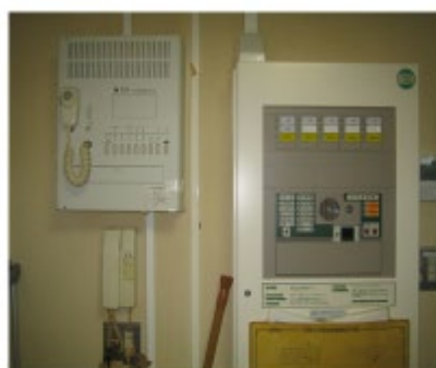
右: 火災受信器 左: 放送設備
