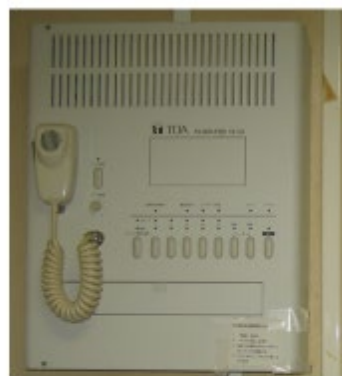
放送設備 (宿舎全体に放送できます)
