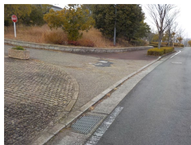
構内道路 (陥没)
