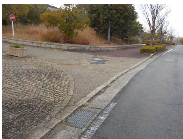
構内道路 （陥没）
