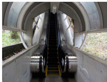
外部エスカレーター
