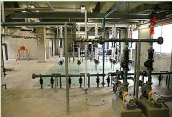
生活排水処理内部
