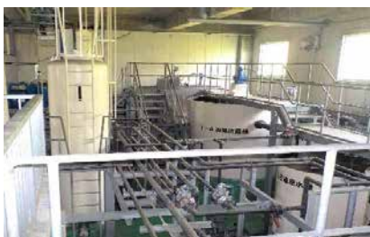
＊ 実験排水処理設備
