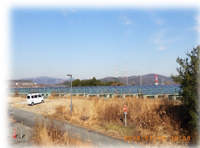
●太陽光発電設備
